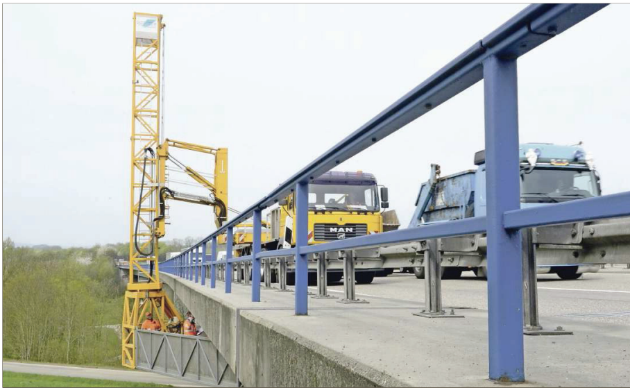
Oben hui, unten pfui: An vielen Brücken sieht man die Mängel erst auf den zweiten Blick.
